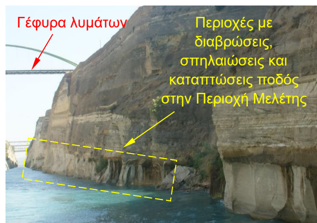
2δ. Το δυτικό τμήμα της περιοχής μελέτης (9/2011) όπου διακρίνεται η πλήρης απουσία τοίχου ποδός και η ύπαρξη αποφλοιώσεων και σπηλαιώσεων στους κατώτερους μαργαϊκούς οριζόντες.
